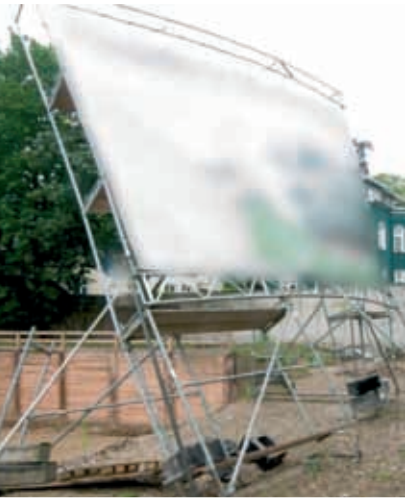
Eine Konstruktion, die offensichtlich den auftretenden Windlasten nicht gewachsen ist (Foto: www.chrickel.eu )
