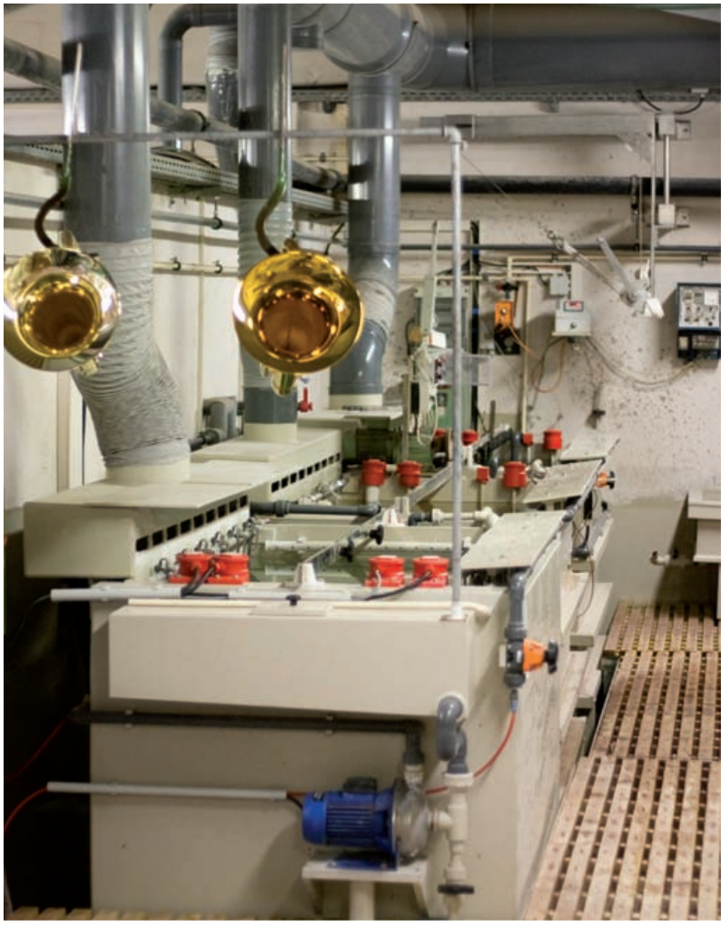
Galvanisierungsanlage der Firma B & S in Markneukirchen im Vogtland. (Bilder B&S)
